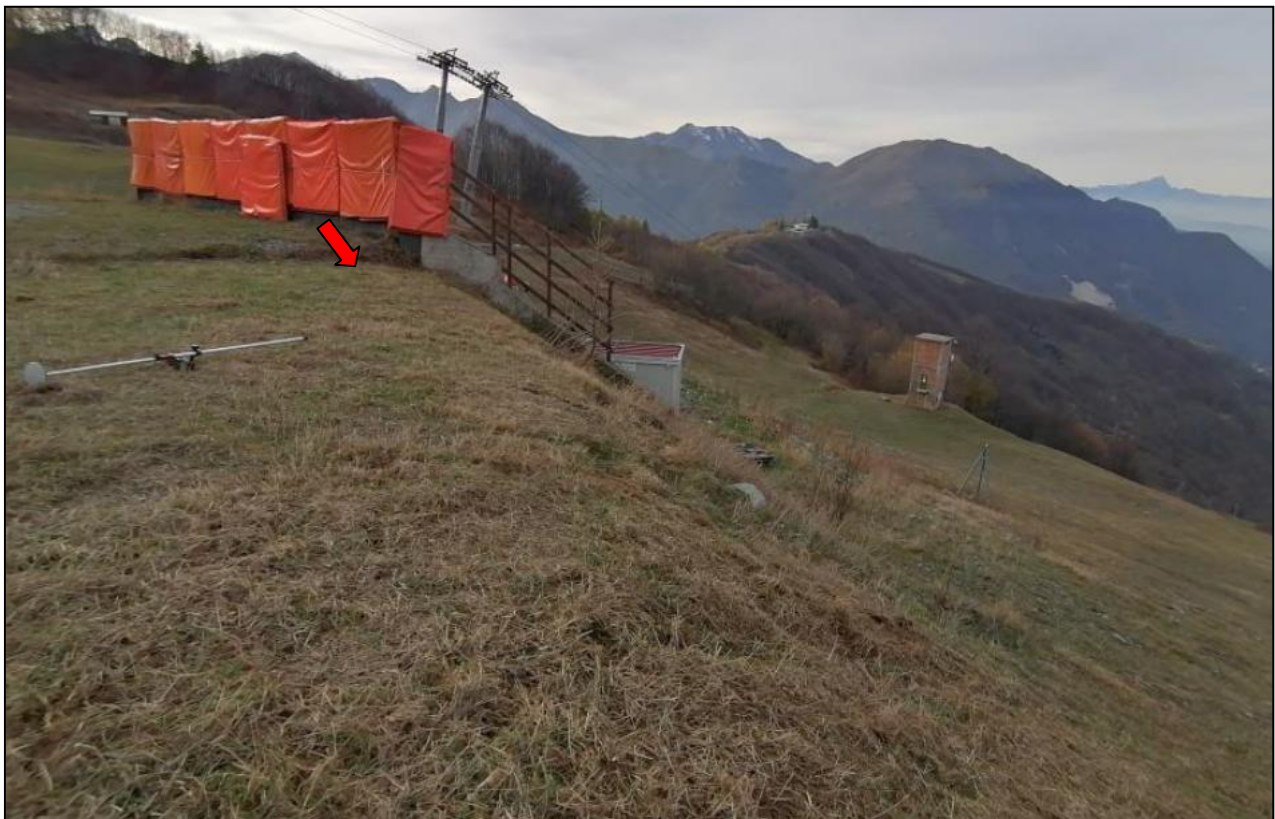
Foto 10 - Sito del fabbricato della nuova stazione di pompaggio, a fianco dell'attuale magazzino interrato a valle della stazione di partenza della Seggiovia Alpetta.
